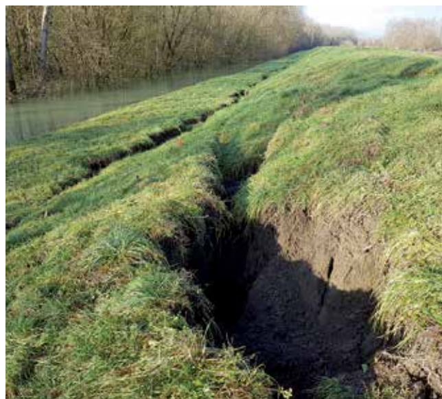
Štete od potresa na vodnim građevinama (2020.) (foto T. Novosel)
