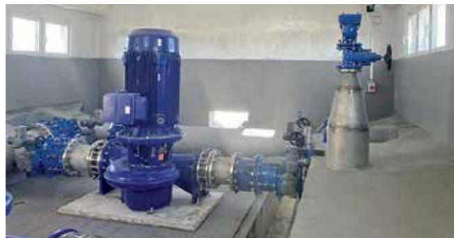
Unutrašnjost precrpne stanice Komorovac
