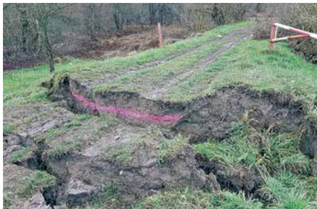
Razmjeri poprečnih oštećenja nasipa od potresa, lokacija Palanjek
